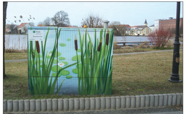
Pumpwerk Schaltschrank Seesallee
