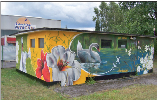
Pumpwerk Schaltschrank Frankfurter Straße
