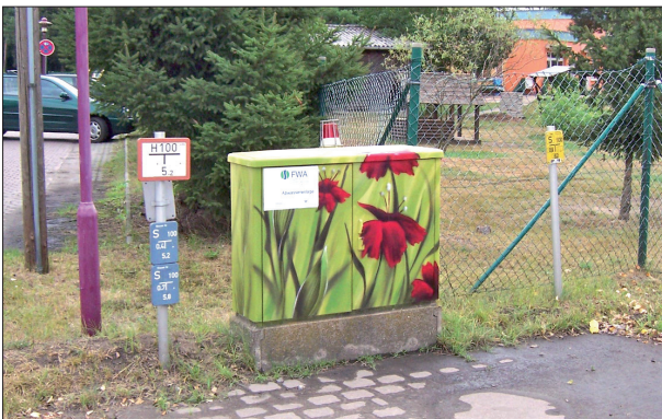
Pumpwerk Schaltschrank Jahnstraße
