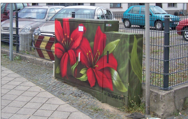
Pumpwerk Schaltschrank Beeskower Straße/Fischerstraße
