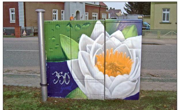
Pumpwerk Schaltschrank Seesallee
